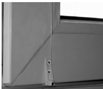
Рис. Установленный кронштейн без крышки
